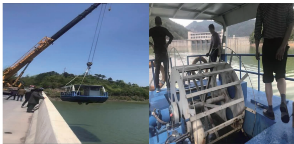
图1 应急处置投放使用过程及主要装置
